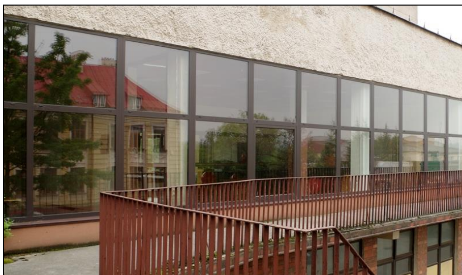
Fotografia 5 – okna do wymiany
