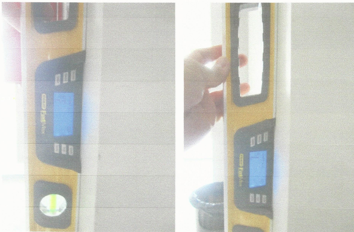
Rys. 30. Nachylenie badanych ścian Wydziału Prawa i Administracji UŚ
