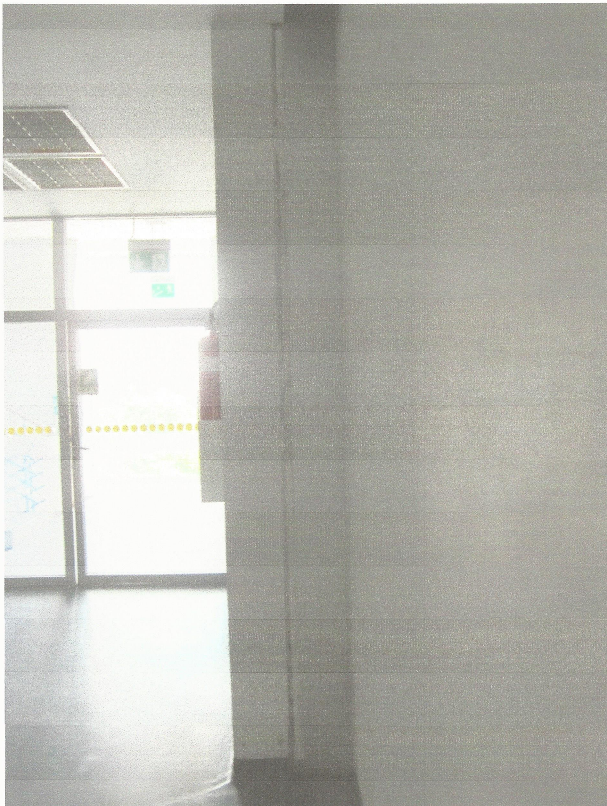
Rys. 22. Rozwarcie dylatacji między segmentem środkowym i południowym na staniej kondygnacji
