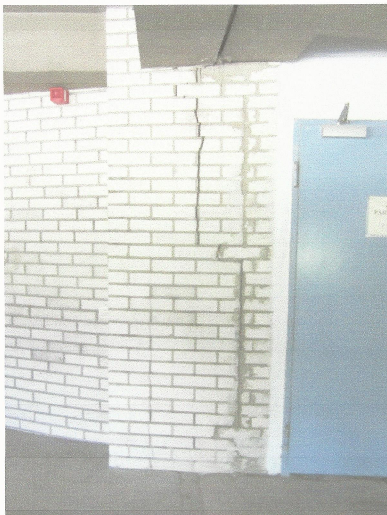
Rys. 23. Zarysowanie ścianki zabudowanej w garażu na dylatacji segmentem środkowym i południowym
